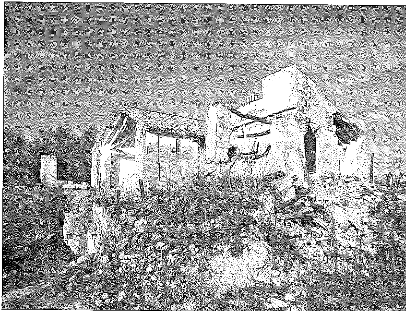
Foto 5: Ruinas de la casería de don Baltasar de Puertas, en la actualidad.
