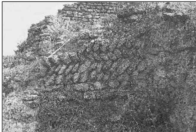
Fig. 8. Aparejo de sillarejos en disposición sesgada alterna, de tipo "granadino", característico de la arquitectura defensiva del siglo XIV
