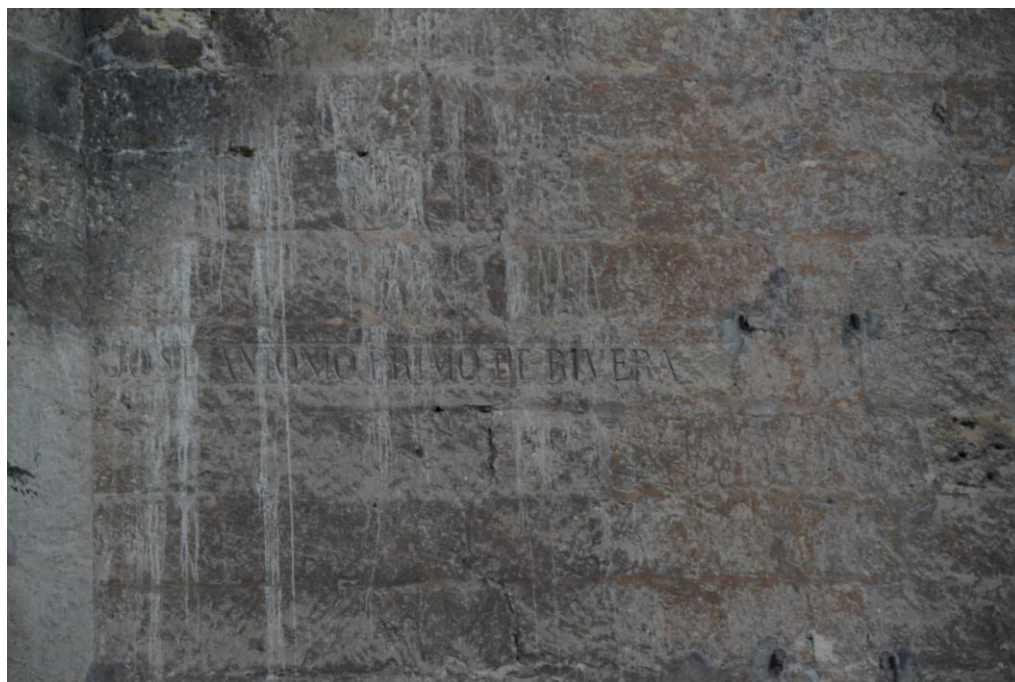
Estado actual de la inscripción en la Torre de la Malmuerta dedicada al fundador de la Falange: JOSÉ ANTONIO PRIMO DE RIVERA y restos de los clavos que sostenían la cruz de madera (Foto: J. Padilla).
